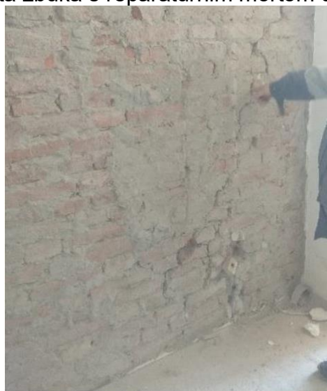
Pukotine širine veće od 10 mm
