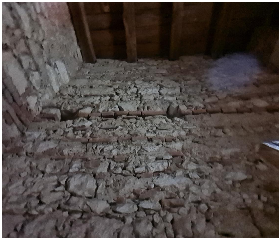
Slika 30. Umjereno konstrukcijsko oštećenje
