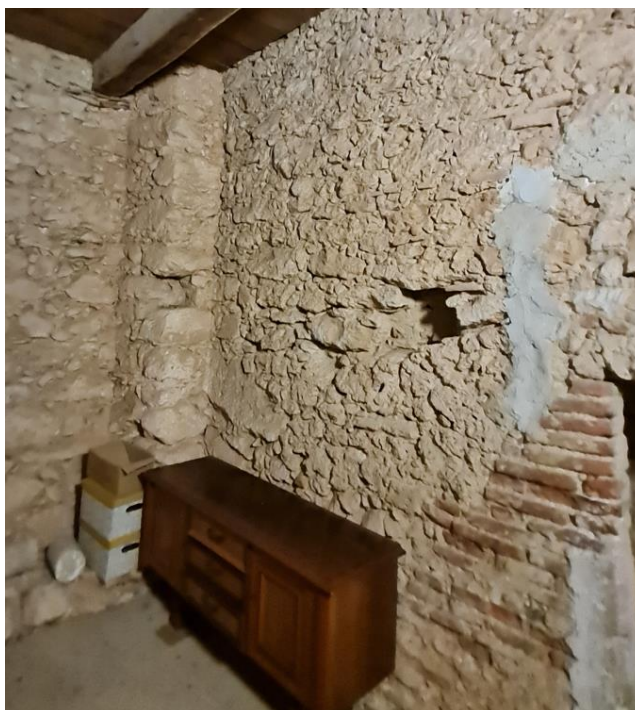
Slika 28. Umjereno konstrukcijsko oštećenje
