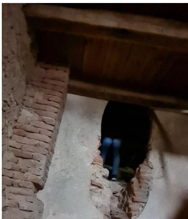
Slika 29. Umjereno konstrukcijsko oštećenje
